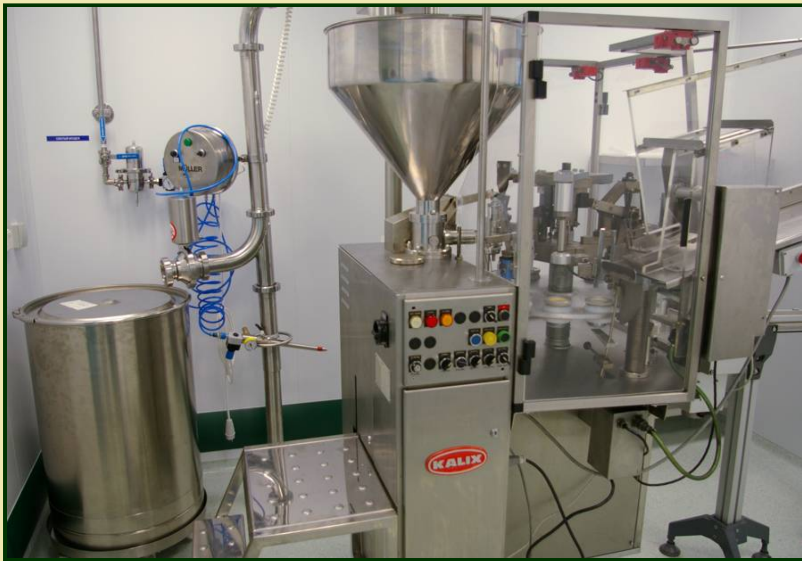
Помещение фасовки. Система подачи мази в бункер тубонабивной машины Kalix.
